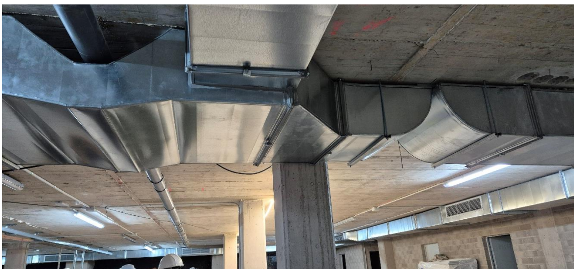
Instalaciones zonas comunes
